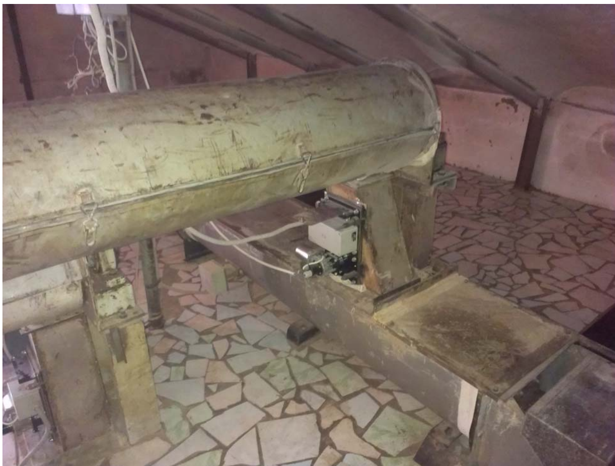
Фото установки влагомера на конусе выхода из БШУ
