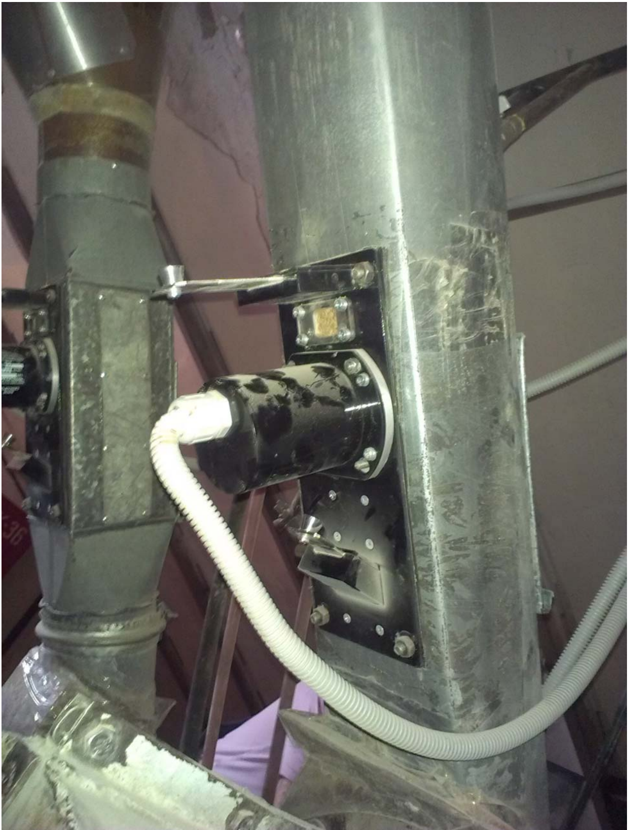
Фото установки влагомера в зернотоке на входе в БШУ
