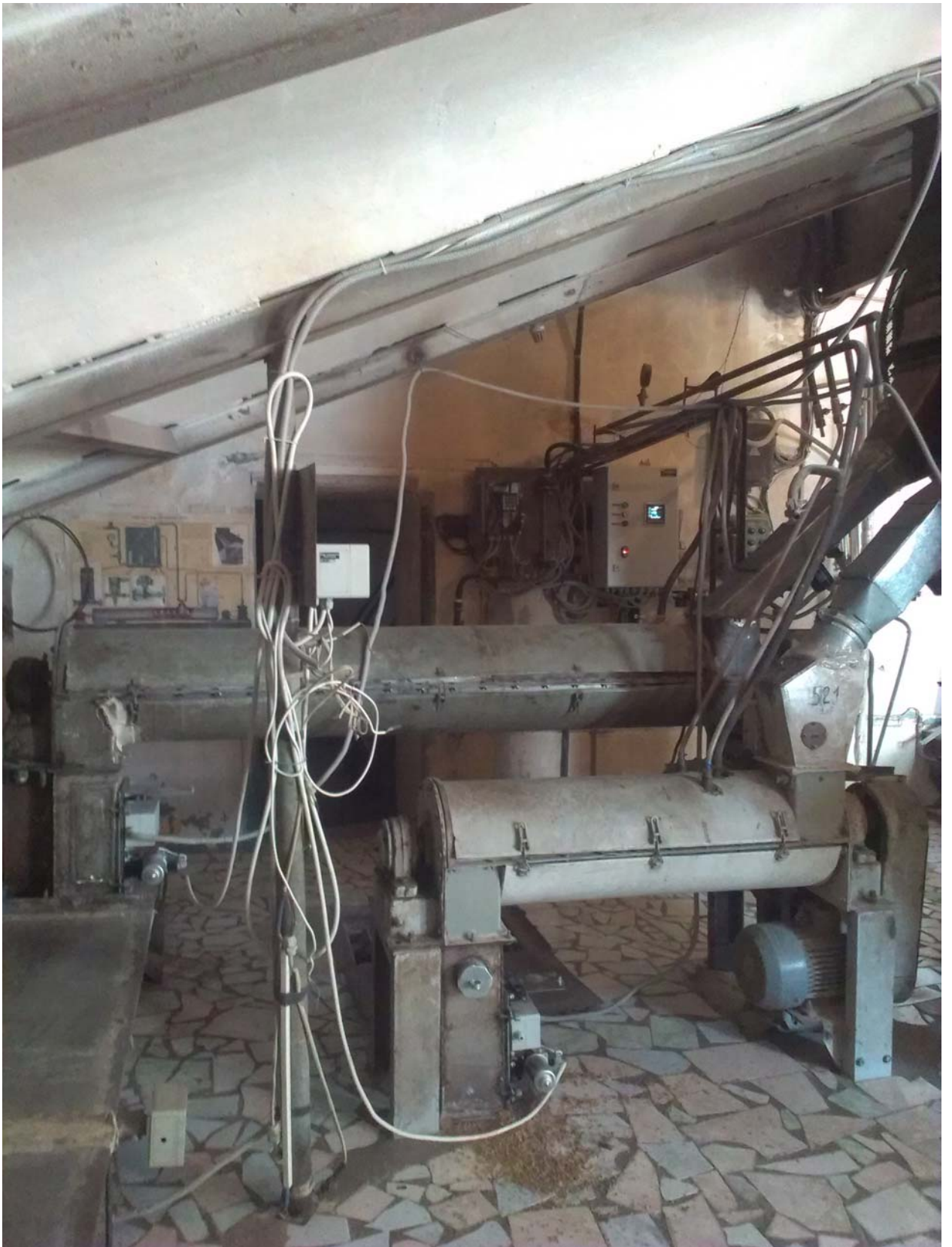
Общий вид участка подготовки зерна с 2-мя БШУ
