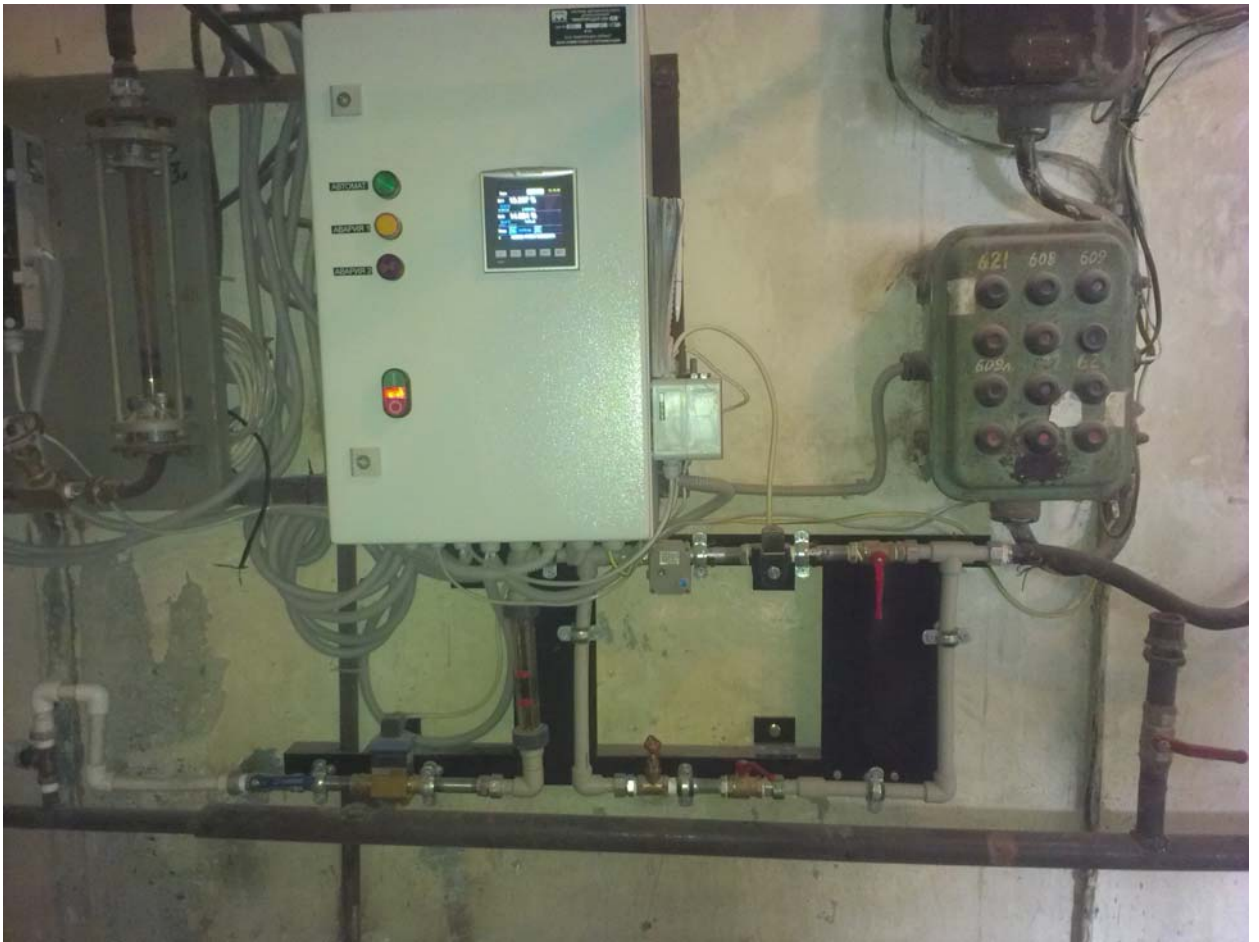
Общий вид гидропанели системы
